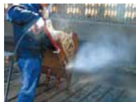
●コンクリートの剥離
